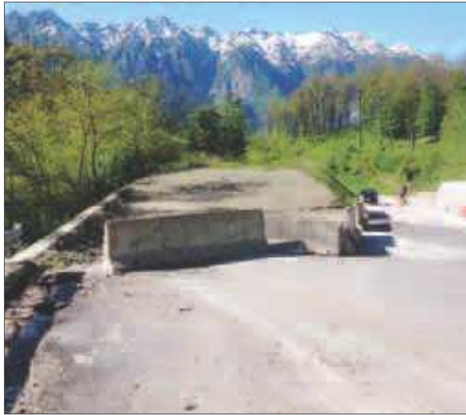
Il dissesto sulla strada che porta in Tesino (Foto Nicoletta Brandalise)
