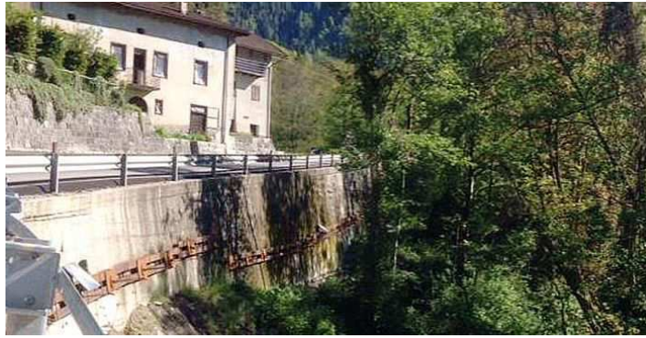
Il tratto di strada lungo la Provinciale 78 che sta cedendo o dove sabato si terrà la protesta dei tesini
